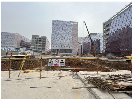
废水处理站、事故池现状图片一
