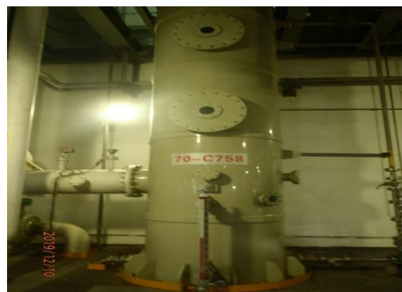
10、20、30、40 线共用洗涤塔现状图
