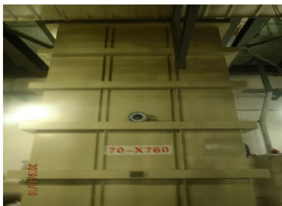
10、20、30、40 线共用填料除雾器现状图
