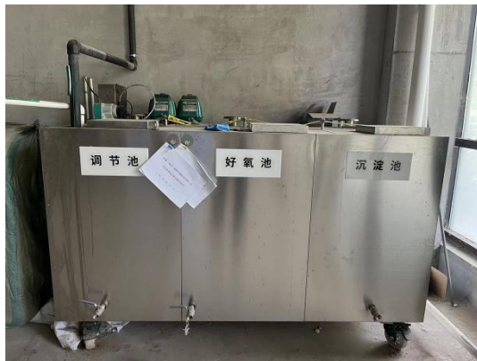
废水预处理设施
