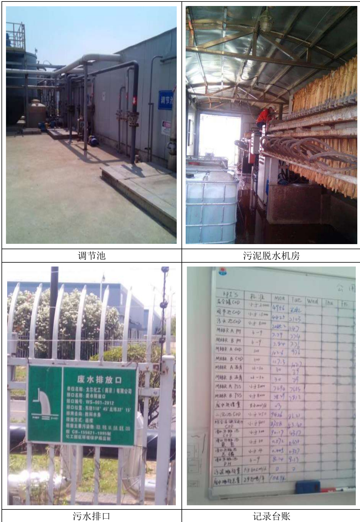
图 7.1-6 废水处理站现场图
